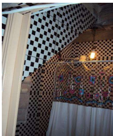
Figura 4. Revestimento cerâmico imitando pastilhas.
