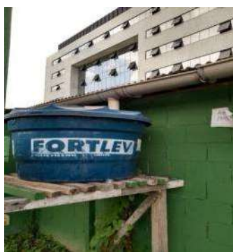
Figura 52. Captação de água da chuva através de calha.
