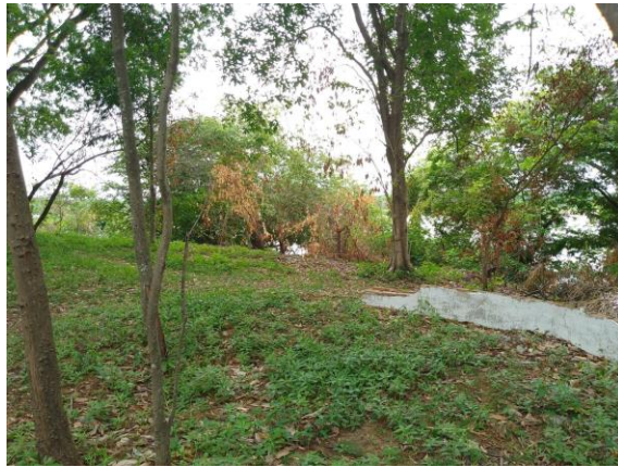
Figura 5. Parque Ambiental Acarape, mobiliários originais em ruínas, 2022.
