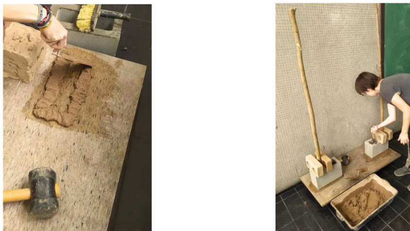
Figura 2: Confecção da base e fixação da estrutura principal vertical. Fonte: os autores (2023).
