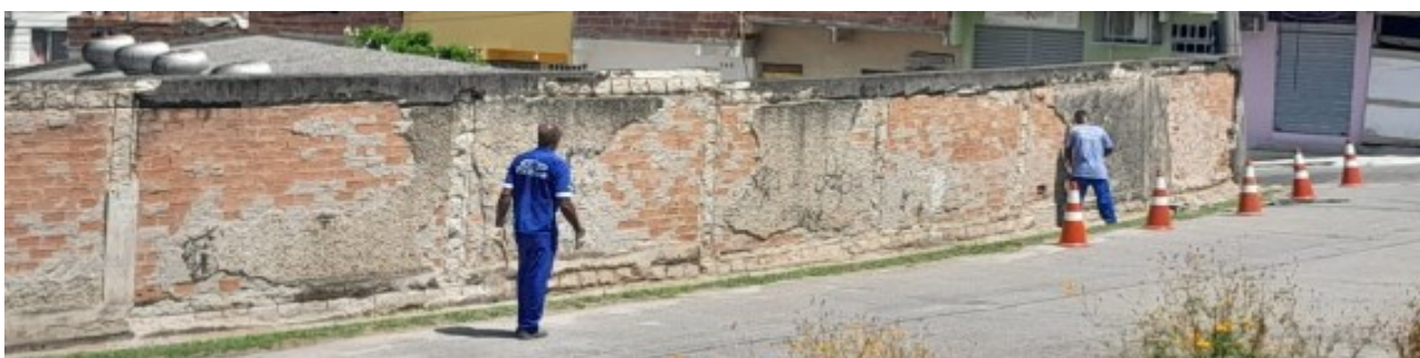
Figura 1: Estado de conservação do muro.
