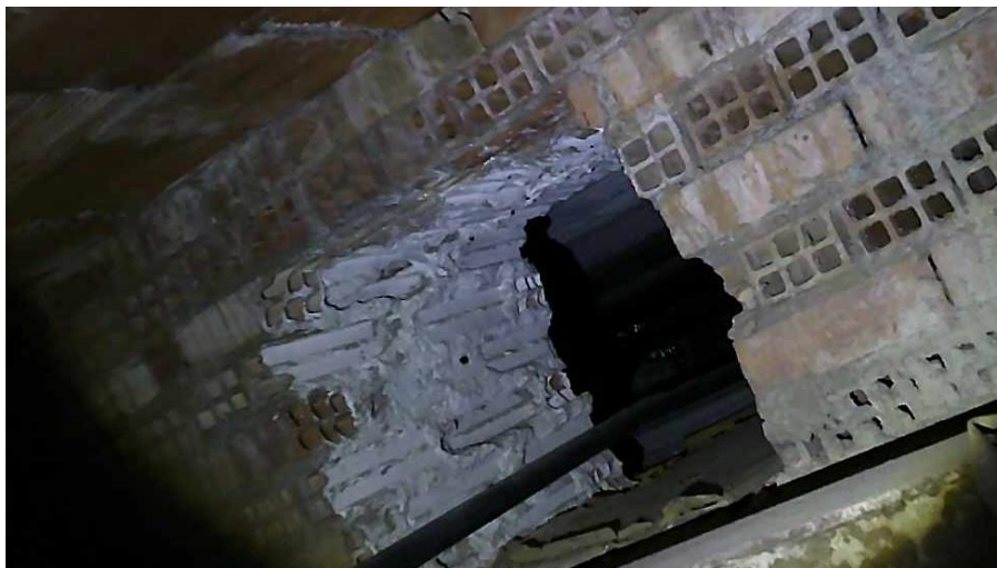
Figura 5 – Vistoria teste em entreforro do 3º pavimento do Pavilhão Mourisco - Fonte: DPH (2019)
