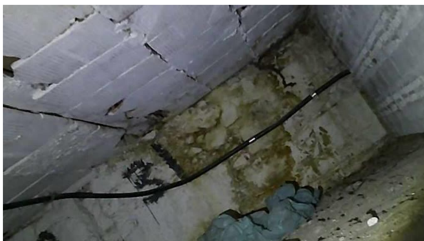
Figura 6 – Vistoria teste em entreforro do 3º pavimento do Pavilhão Mourisco - Fonte: DPH (2019)
