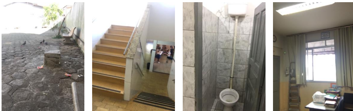
Figura 4 – Alguns ambientes escolares e problemas de acessibilidade -
