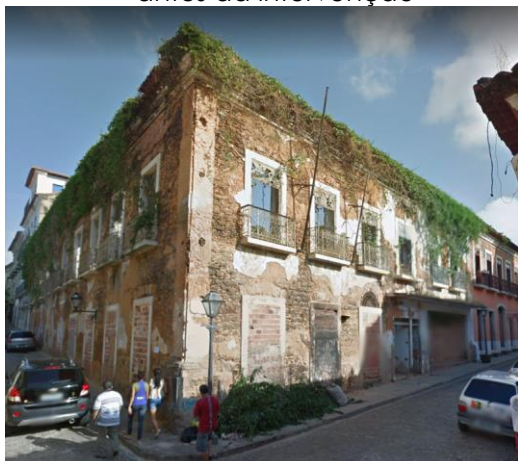
Figura 6 – Imóvel Rua da Palma 195/205 antes da intervenção
