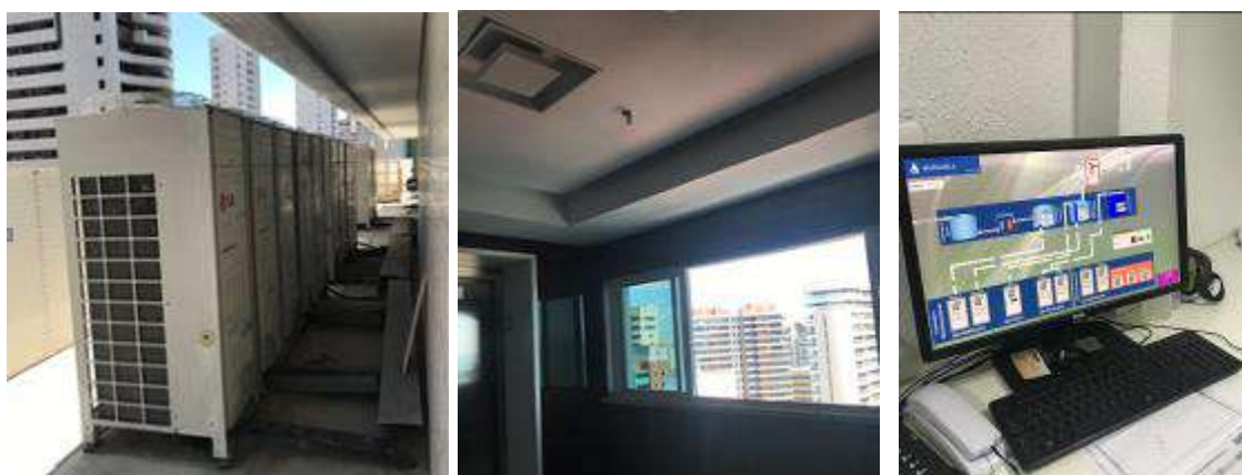
Figura 9 – Sistema de ar condicionado, iluminação led, elevadores e automação
