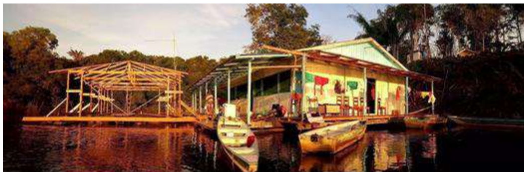
Figura 2 – À esquerda, a estrutura de madeira de uma casa flutuante ainda em construção. À direita, casa flutuante já finalizada -
