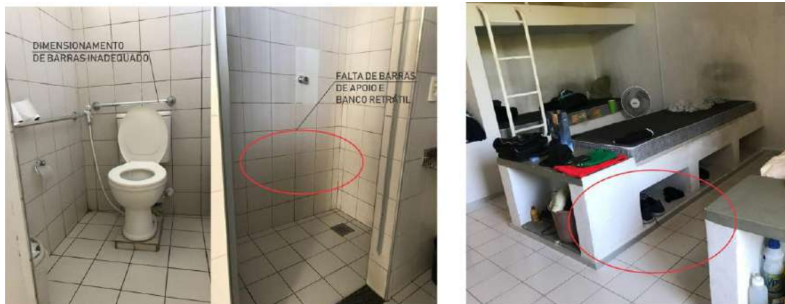
Figuras 22, 23 e 24 – Sanitário, área do chuveiro, área do dormitório - Fonte: Disciplina de Desenho Universal - Curso de Arquitetura e Urbanismo UFC (2018)
