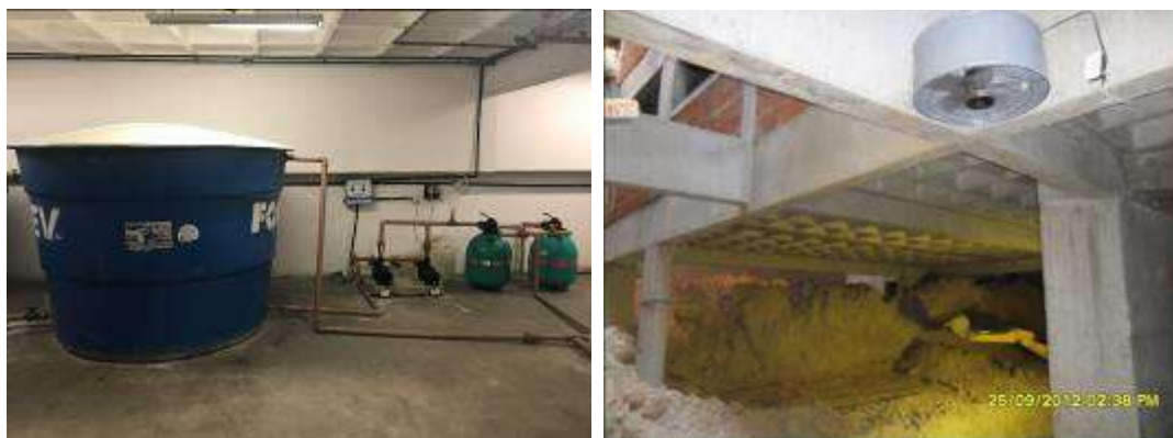
Figura 7 – Estação das águas pluviais e Exaustor no subsolo
