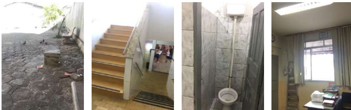
Figura 4 – Alguns ambientes escolares e problemas de acessibilidade -
