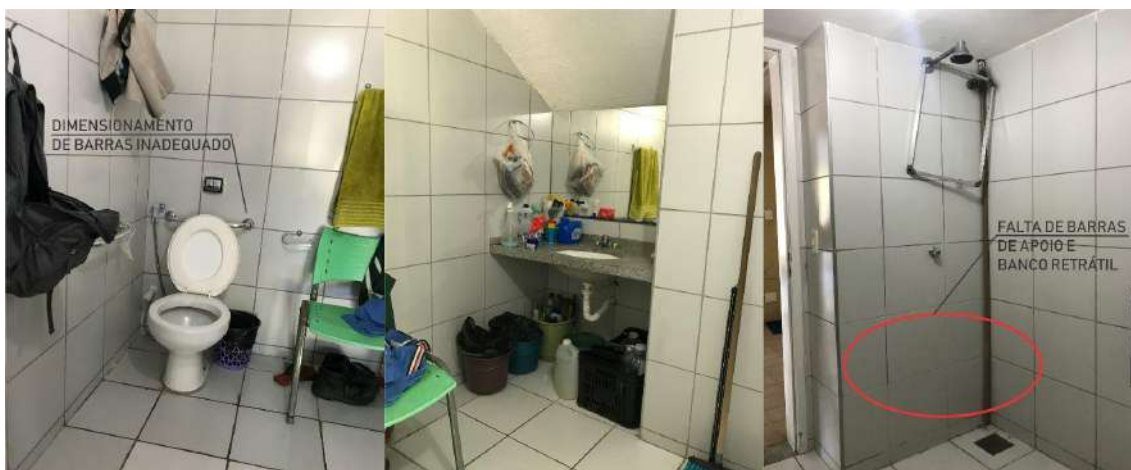
Figuras 11, 12 e 13 – Bacia sanitária, lavatório e chuveiro no banheiro acessível térreo -
