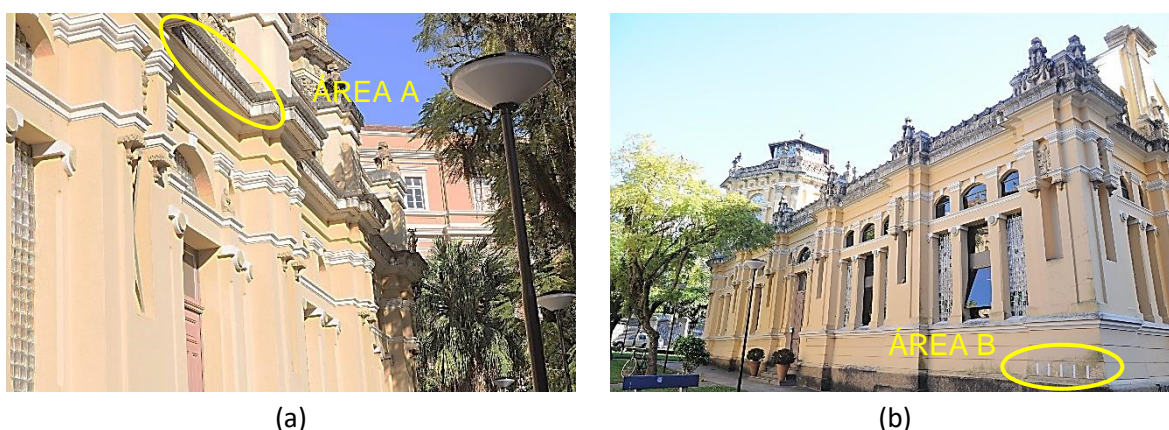
Figura 1 – Fachadas das edificações históricas analisadas: a) Área A no prédio Chateau; b) Área B no prédio Castelhinho
