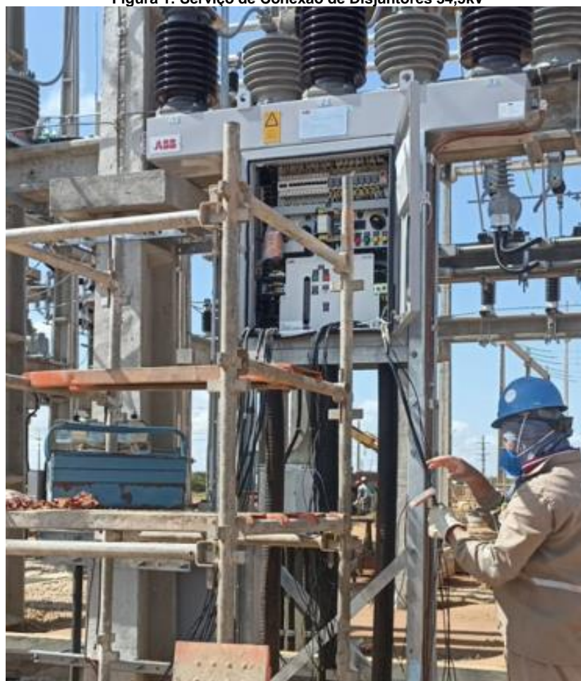
Figura 1: Serviço de Conexão de Disjuntores 34,5kV
