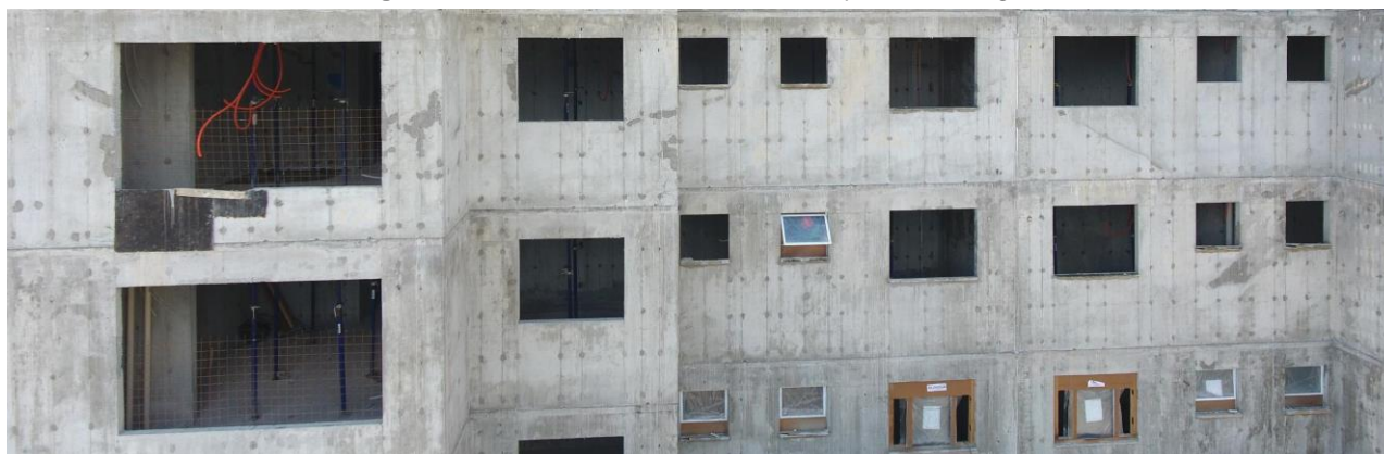
Figura 5: Fachadas com marcas das formas após a concretagem
