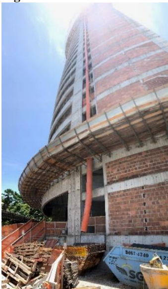
Figura 2 – Duto coletor fazendo o transporte de resíduos até a caçamba estacionária
