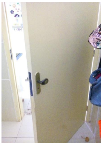
Figura 8: Porta do banheiro
