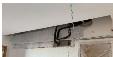
Figura 2 – Registro fotográfico da ocorrência da sanca fechada não executada e da análise de causa raiz
