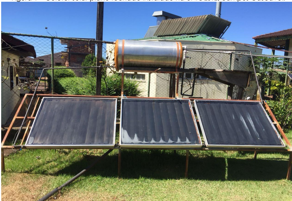
Figura 1 – Coletor solar plano fechado instalado na UNIOESTE, campus Cascavel.
