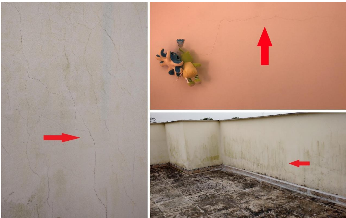
Figura 7 – Fissuras no revestimento argamassado
