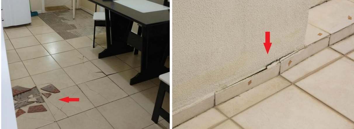
Figura 6 – Deslocamento e estufamento de peças cerâmicas
