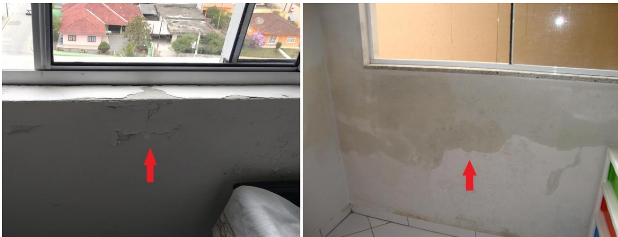
Figura 5 – Danos à pintura e manchas de umidade devido à infiltração
