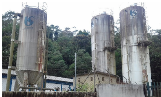
Figura 4 – Poço da Sabesp
