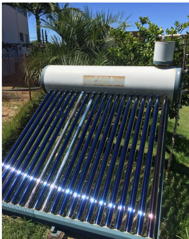
Figura 2 – Coletor solar tubular a vácuo tipo all-glass instalado na UNIOESTE, campus Cascavel.
