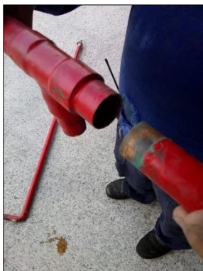
Figura 2 - Falha em soldagem de tubulação da Odontologia
