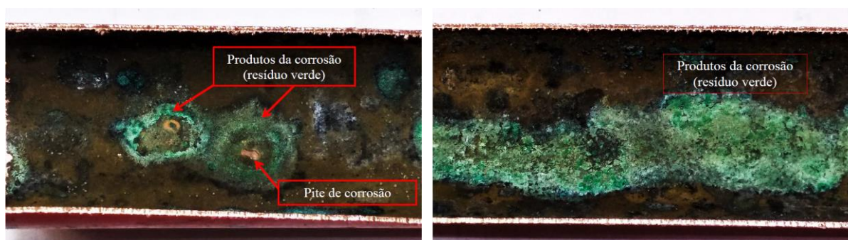
Figura 8 - Tubo de cobre com superfície interna apresentando pites e produtos de corrosão esverdeado
