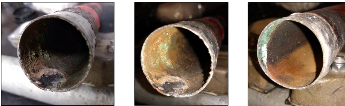
Figura 6 – Tubos com resíduos de corrosão
