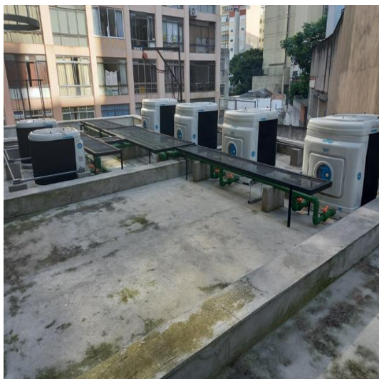
Figura 10 – Bombas de Calor Elétricas
