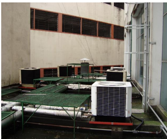
Figura 7 – Bombas de Calor Elétricas
