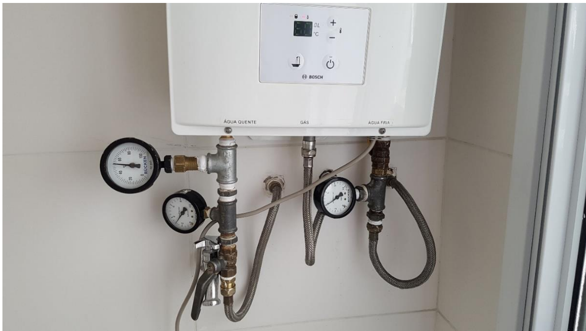
Figura 7 - Manômetros e termômetros instalados a montante e a jusante do aquecedor
