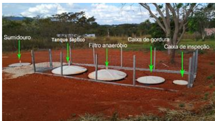
Figura 9 - Novo Sistema de tratamento de esgoto.
