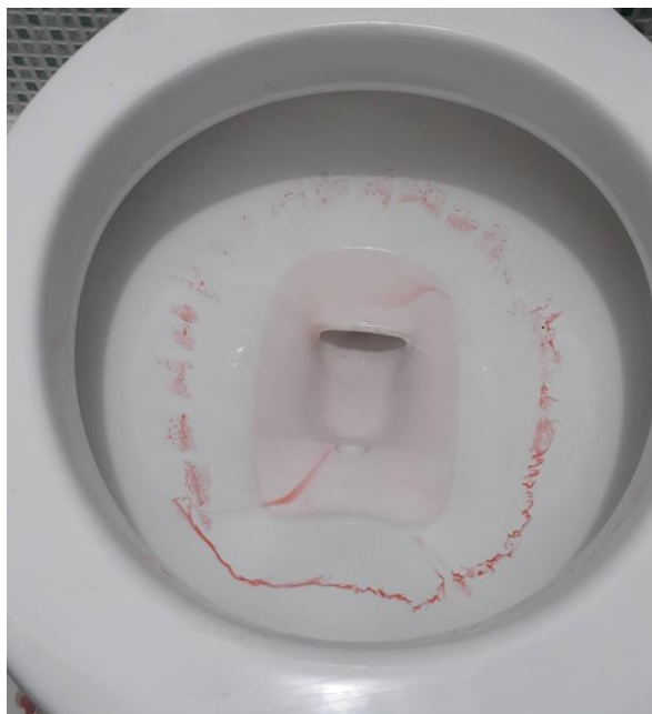
FIGURA 5 – Detecção de vazamento na bacia sanitária
