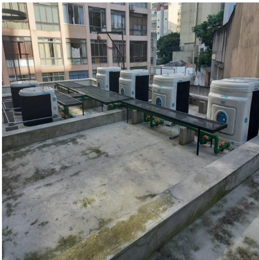
Figura 10 – Bombas de Calor Elétricas
