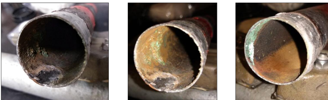
Figura 6 – Tubos com resíduos de corrosão
