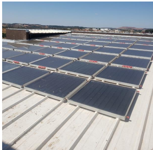
Figura 2 – Placas de Aquecimento Solar
