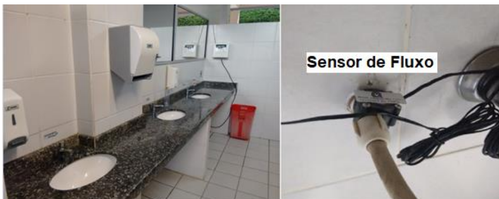
Figura 1 - Banheiro e sensor de fluxo
