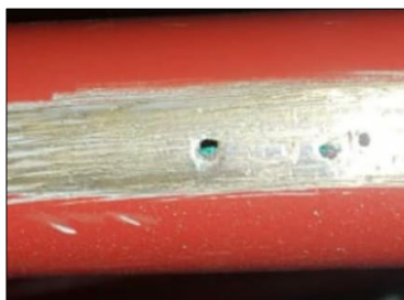
Figura 4 - Tubulações dos ramais com furos
