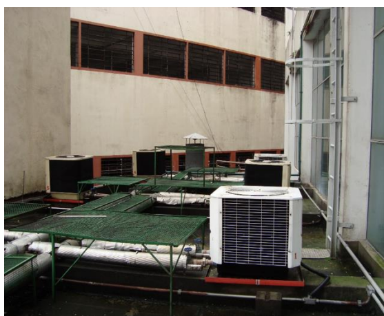
Figura 7 – Bombas de Calor Elétricas
