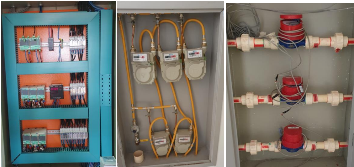
Figura 5 – Medidores individuais de energia, gás e água na MUC.
