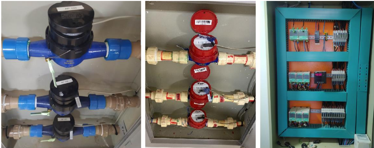
Figura 2 – Sistema de Medição Individualizada (SMI): hidrômetros de AF e AQ, e painel.
