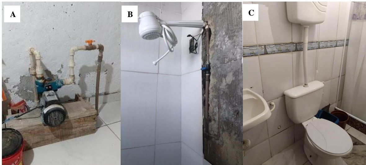
Figura 6 – Falhas identificadas nas Residências
