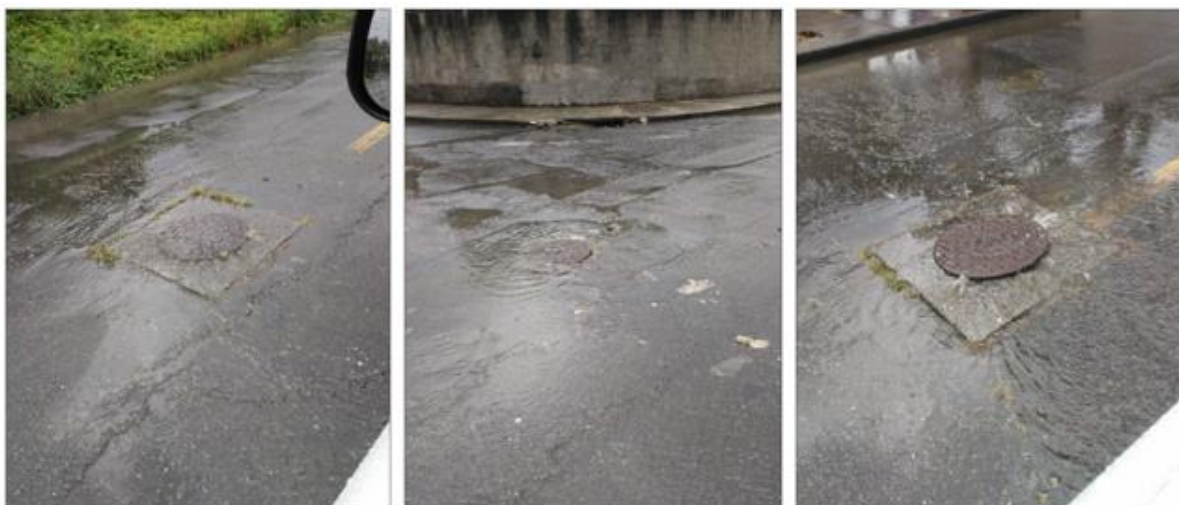
Figura 1 – Pontos de extravasamentos de esgoto na Rua Ernesto Friedrichsen
