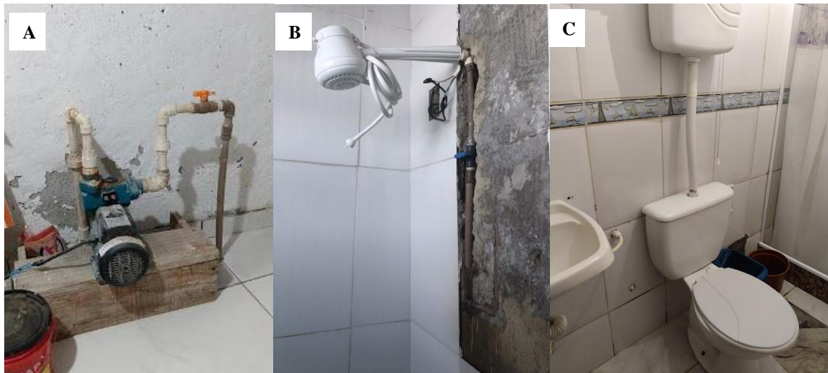
Figura 6 – Falhas identificadas nas Residências
