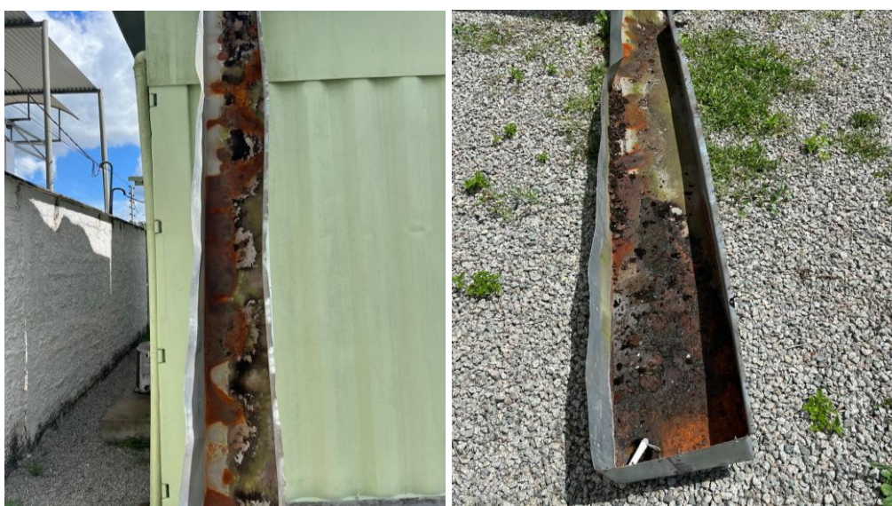
Figura 3 – Calha de aço galvanizado em processo de corrosão.
