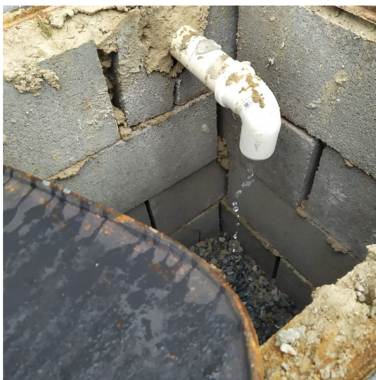
Figura 2 – Sumidouro de jardim para infiltrar a água condensada no solo.
