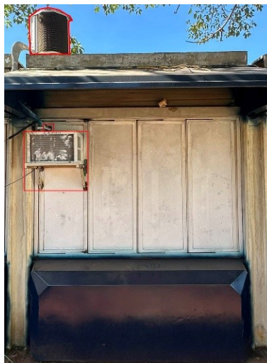
Figura 7 – Equipamentos instalados nos painéis de fachada e na cobertura
