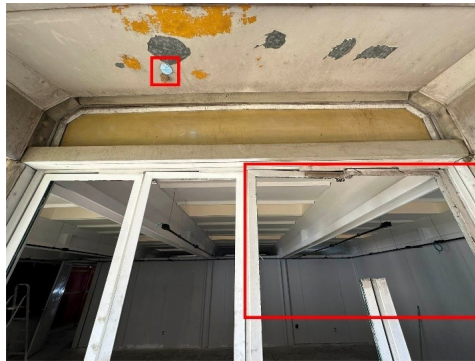
Figura 8 – Danos nos caixilhos metálicos dos painéis de esquadrias e perfuração da pestana de proteção solar
