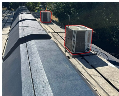
Figura 9 – Condensadoras na cobertura
