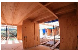
Figura 5 – Elementos estruturais em CLT
