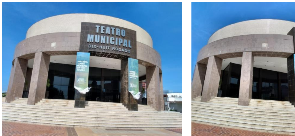
Figura 1- Destacamento do granito. Fachada principal
