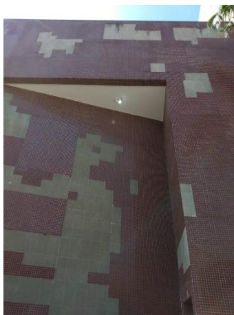
Figura 3-Descolamento. Fachada lateral direita
