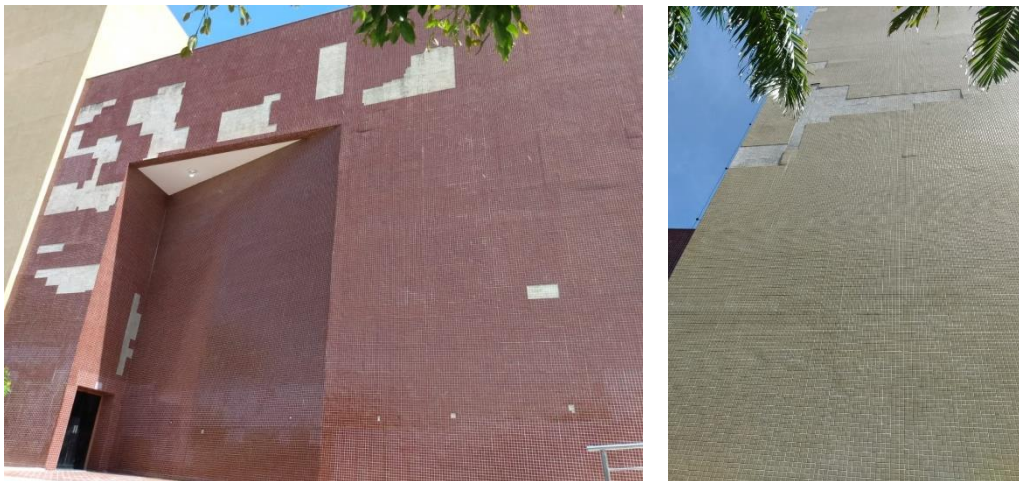
Figura 2-Destacamento das pastilhas cerâmicas. Fachada lateral esquerda
