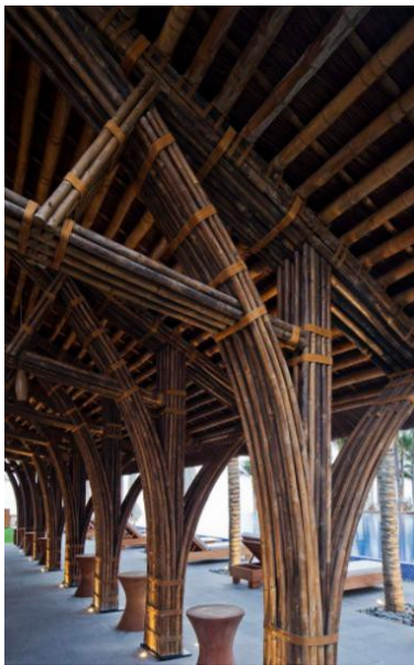
Figura 9 – Detalhe do sistema estrutural com tesouras em feixes de bambus de médios diâmetros
