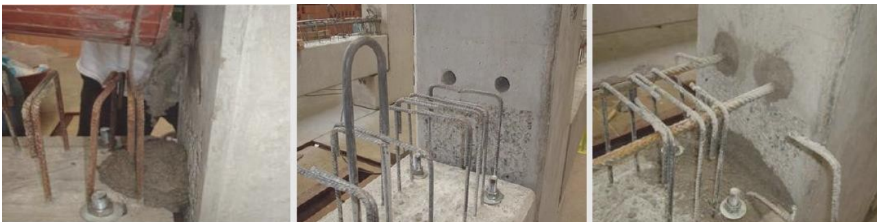
Figura 5 - Grauteamento de bainha: inserção do graute, furo das bainhas e armadura já grauteada (da esquerda para direita).
