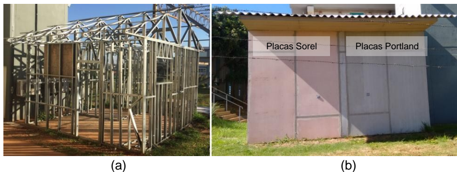
Figura 1 – Protótipo construído: (a) Estrutura em Light Steel Frame e (b) Placas de cimento Sorel e cimento Portland fixadas no protótipo
