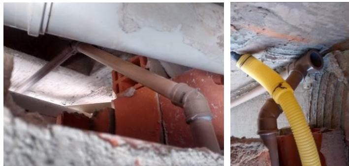
Figura 7 e 8 – Perda incorporada devido interferências de outras instalações.
