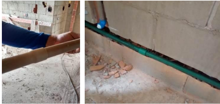
Figura 5 e 6 – Perda incorporada devido a erros de conexão.
