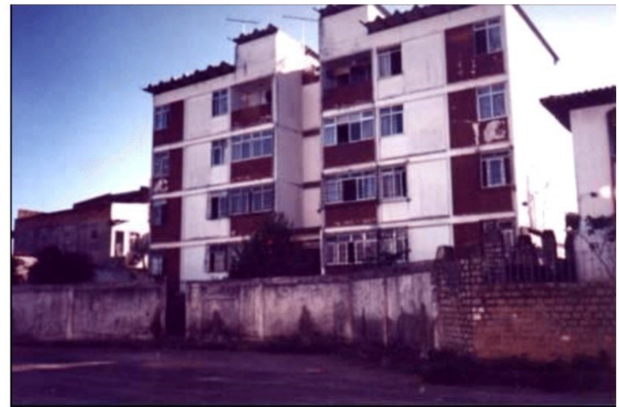
-Campus experimental de Narandiba: Prédio construído em 1978, com tecnologia da Alfredo Matias -módulos tridimensionais pré-fabricados- Salvador 2000
