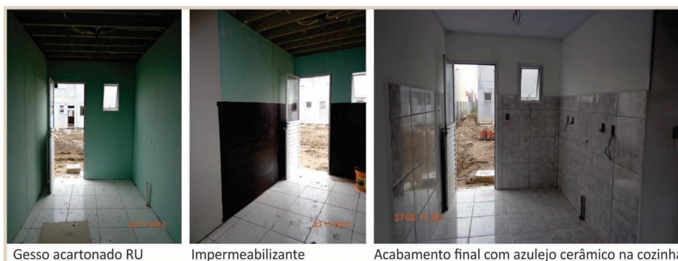
Figura 7 – Colocação de gesso, impermeabilizante e azulejo na parede da cozinha no canteiro
