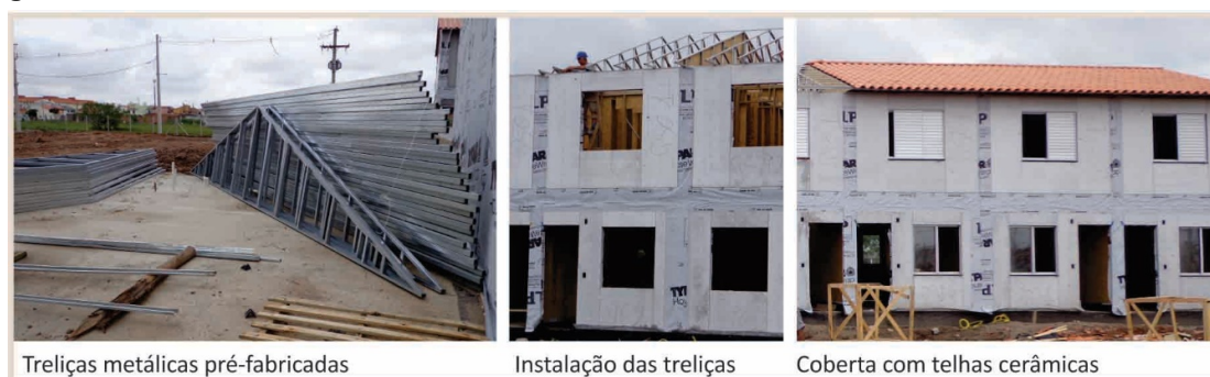
Figura 5 – Colocação das estruturas metálicas e da telha cerâmica da cobertura no canteiro
