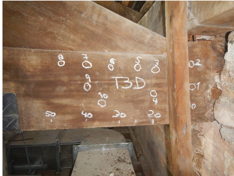
Figura 3. Indicação dos locais perfurados e gráficos gerados durante a avaliação com o resistógrafo na Treliza T3. Os números na parte de baixo da tesoura indicam a distância em cm a partir do apoio na parede. A) Furo nº 3. B) Furo nº4 da tesoura. C) Furo nº7. D) Furo nº9. O Eixo X apresenta a distância (cm) percorrida pela broca.
